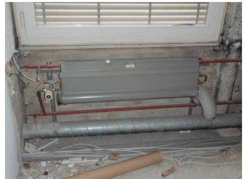
Spritzasbest als Wärmeisolation auf Stahlträger (rechts von Heizung/Lüftung)
