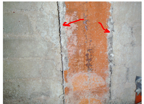
Ungenügend gereinigter Stahlträger. Solche Elemente müssen noch einmal saniert werden.
