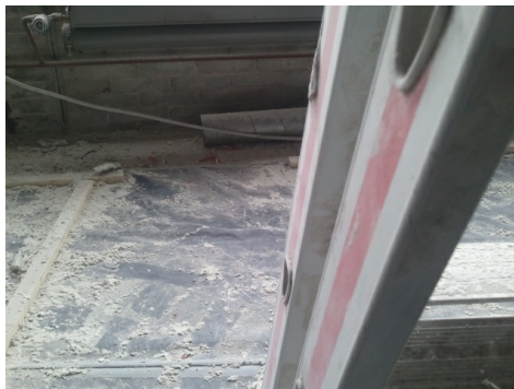
Am Boden verteilter Spritzasbest während Sanierung. Solche Verunreinigungen sind während der Sanierung nicht zulässig. Ausserdem muss das Material während der
