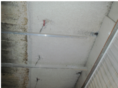
Spritzasbest als Wärmeisolation an Betondecke
