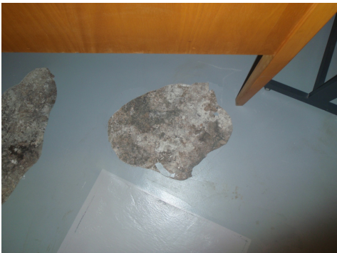
Kunstharz-Bodenbelag mit Asbest in der Haftschrift.
