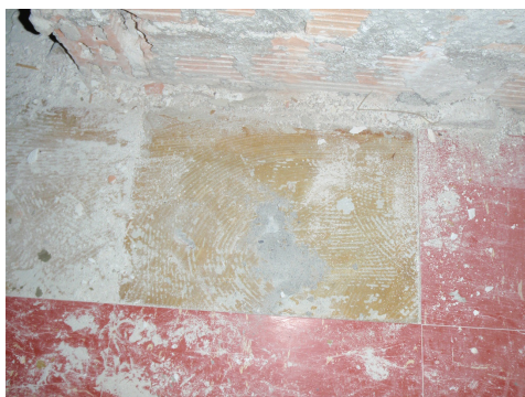
Kunststoff-Kleber unter Vinyl-Platten (hier ohne Asbest)
