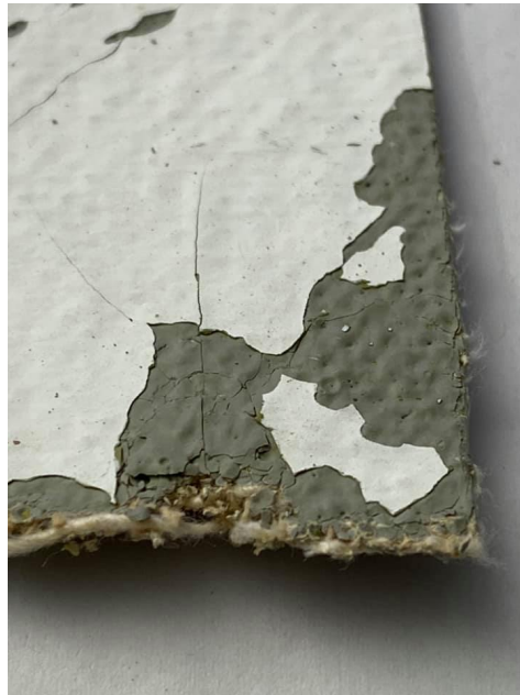
Stramin Wandbelag mit Asbest im Anstrich und Kleber, Solgeo
