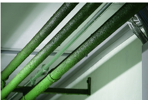
Asbesthaltige Farbe auf Leitungen, Suva
