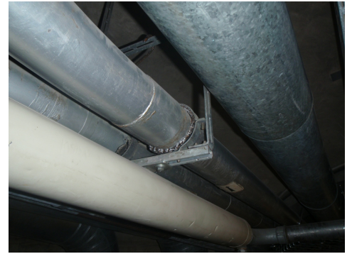
Bande/tissu amiantée sous une bride de tuyau
