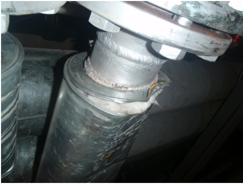
Tissus amiantés sur tuyau.
