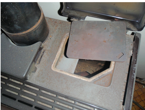
Bande amiantée dans un poêle à mazout
