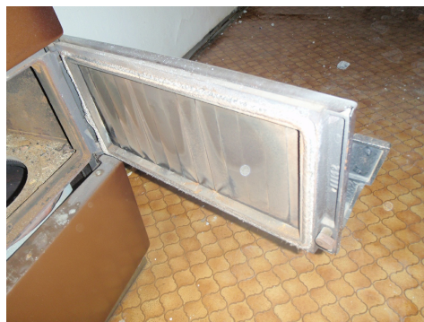
Bande amiantée dans un poêle à mazout
