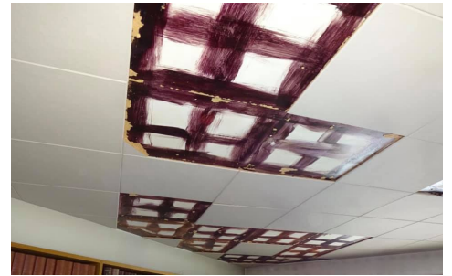
Plaques de faux plafonds avec colle amiantée, Solgeo
