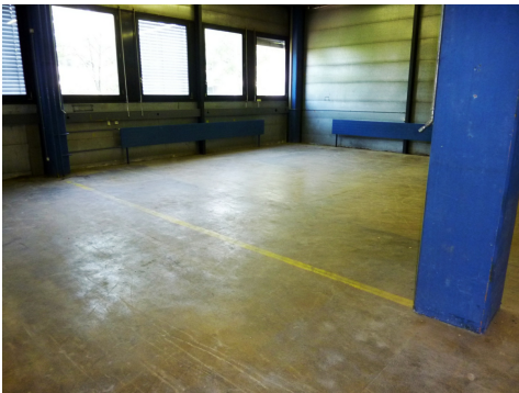
Revêtement de sol en bois-ciment amianté. Photo: Arcadis AG, Simon Küng.
