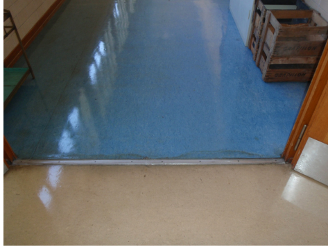
Des revêtements de sol du type linoléum sont susceptibles de contenir de l'amiante.
