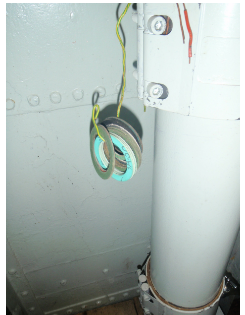
Réserve de joints plats d'étanchéité pouvant contenir de l'amiante
