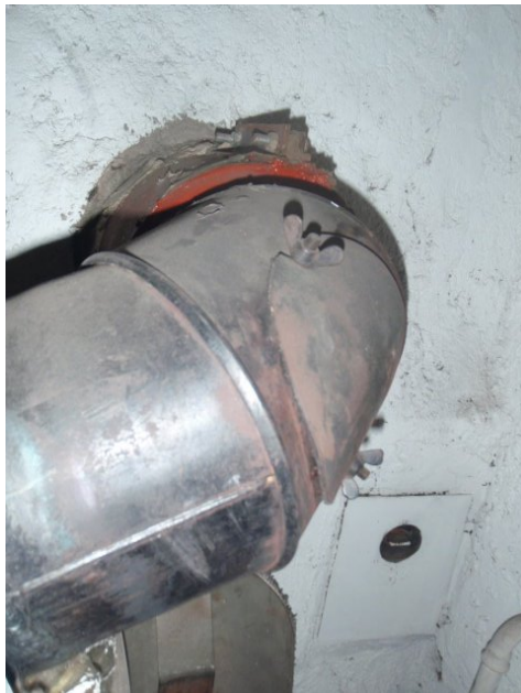
Dans les conduits de cheminées, on trouve parfois aussi des joints d'étanchéité en tissu amianté.
