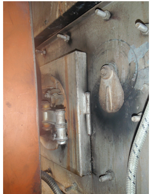
Les joints d'étanchéité des brûleurs à mazout peuvent être en mauvais état et, par conséquent, représenter un certain danger pour la santé des utilisateurs.
