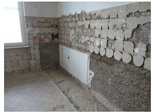
Les «plots de mortier» sont généralement considérés comme non amiantés, selon l'état actuel des connaissances; il n'est donc pas nécessaire de prélever des échantillons. Photo: Carbotech AG.
