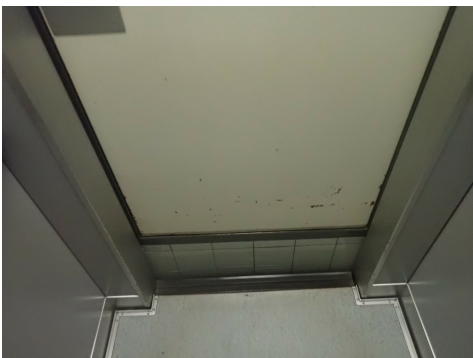
Marquage de l'étage dans la cage de l'ascenseur par une faïence dont la colle peut contenir de l'amiante
