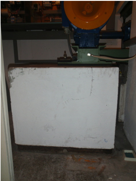
Panneaux en liège bitume dans le socle du moteur d'ascenseur
