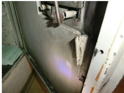
Panneaux légers contenant de l'amiante dans un coffre-fort. Ces panneaux peuvent être contrôlés relativement facilement lorsque le coffre est ouvert en dévissant le volet intérieur. Des échantillons peuvent également être prélevés dans les trous des étagères à l'aide d'un outil pointu. Photo: Ecosens AG, Wallisellen.
