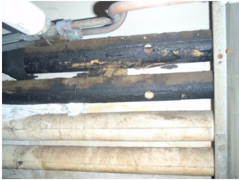
Calorifugeage de conduite avec une peinture bitumineuse contenant de l'amiante
