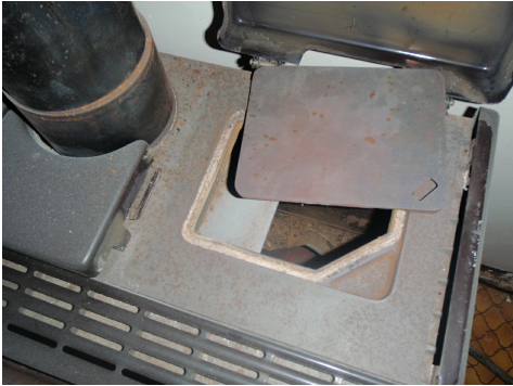
Nastro di amianto in una stufa ad olio.
