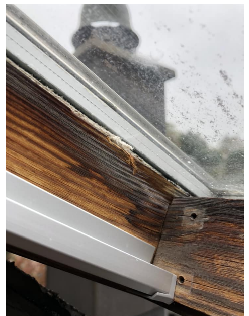
Corda di amianto tra il vetro e il telaio di
