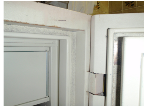
Tessuto di amianto in una cassaforte.
