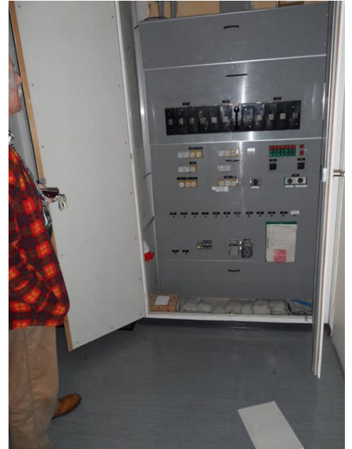
Cuscini di amianto e pannello leggero contenuti amianto sul lato interno della porta di un quadro elettrico.
