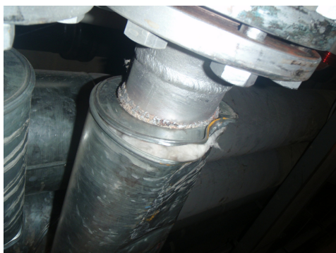
Tessuto di amianto avvolto attorno a un tubo.
