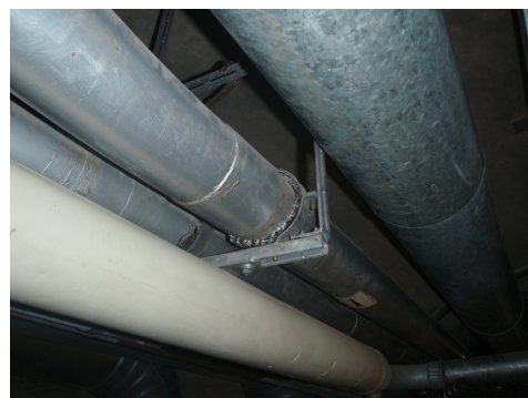
Nastro di amianto applicato sul supporto di una tubazione.
