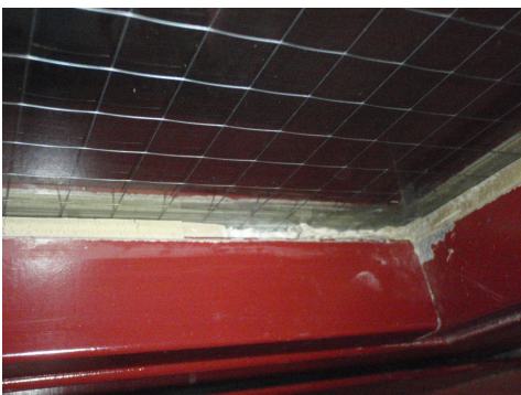
Porta antincendio con tessuto di amianto sotto lo stucco della parte vetrata.
