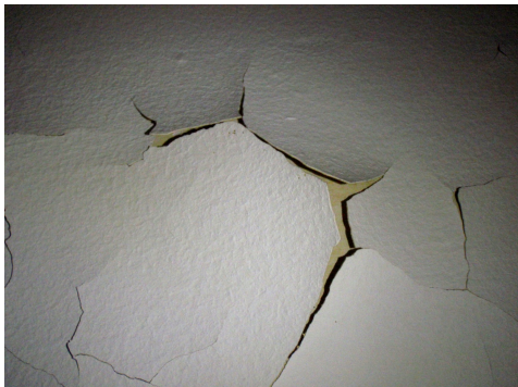
Intonaco che si stacca.
