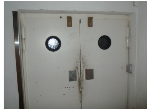
Nelle porte degli ascensori può essere presente del materiale riempitivo contenente amianto.
