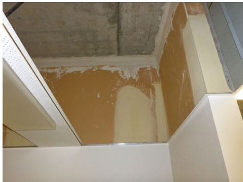
2. Stuccature delle giunzioni tra elementi in cartongesso contenenti amianto. Impiego negli anni '70. (Foto Carbotech AG)
