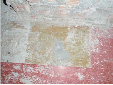
Kunststoff-Kleber unter Vinyl-Platten (hier ohne Asbest)
