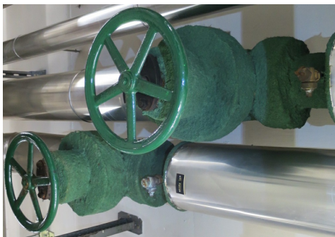
Vernice a spruzzo contenente amianto, tipo Transpirex. (Foto: Diagnostica edilizia Siegart AG)
