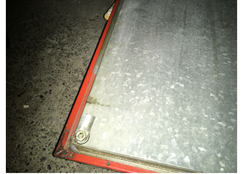
Schiuma contenente amianto nel coperchio di un monoblocco. (Foto: M. Hottarek, GEOTEST AG, 2020)
