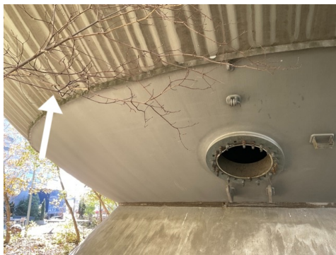
Vernice su un serbatoio di stoccaggio di gas ad alta pressione, TFB Technik und Forschung im Betonbau
