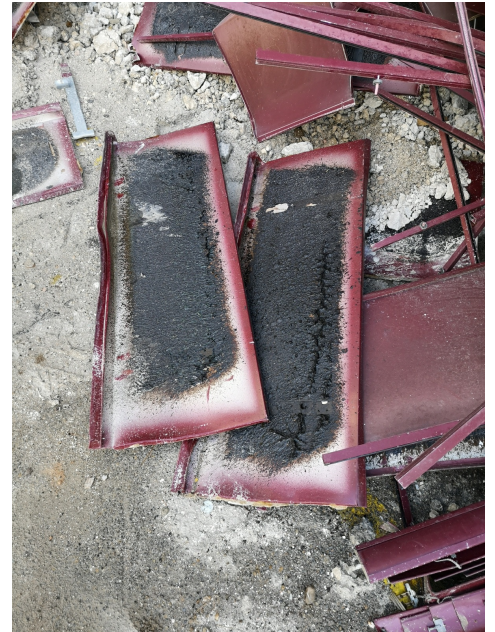
Pannelli di rivestimento di facciate muniti di rivestimento bituminoso contenente amianto. Foto: C. (Campoarmor, Arcadis Schweiz AG)
