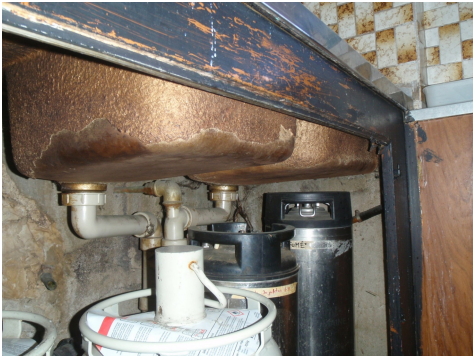
Intonaco/protezione antirombo contenente amianto sotto il lavello.
